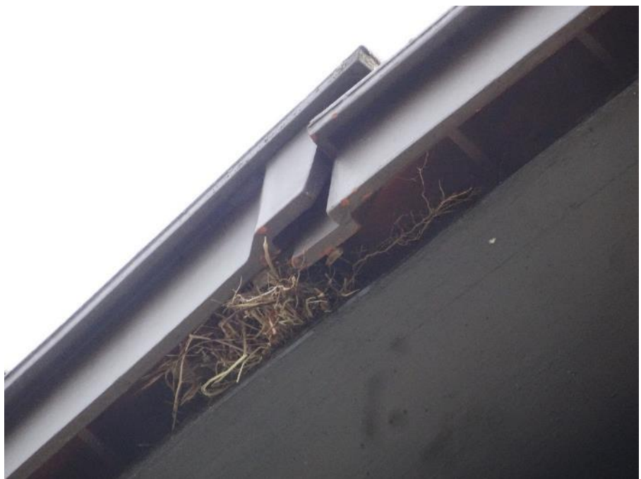
Foto 40: Herausquellendes Nistmaterial am gleichen Gebäude, jedoch auf der gegenüberliegenden Seite. Auch hier werden die Nischen/Höhlen von vielen Haussperlingen als Brutplätze genutzt.
