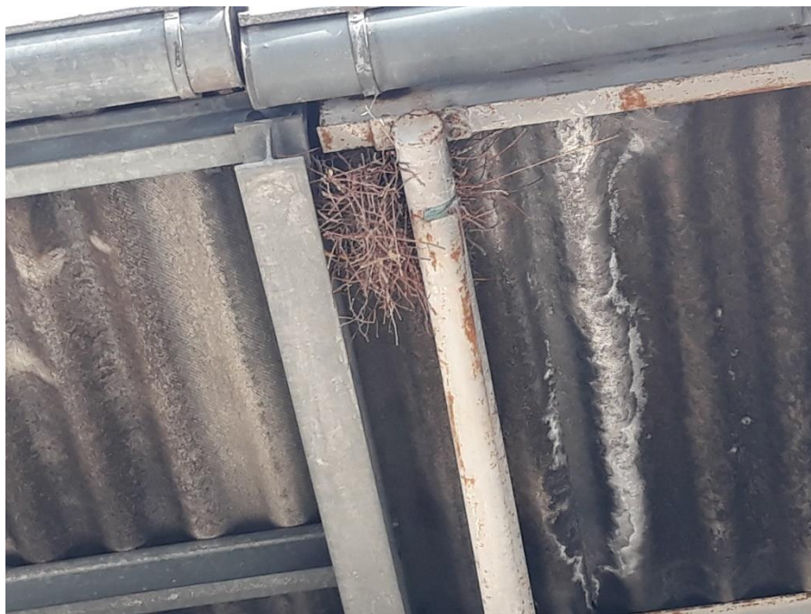
Foto 9: In den Balkenstrukturen des Hallendachs konnte ein größeres Vogelnest nachgewiesen werden.
