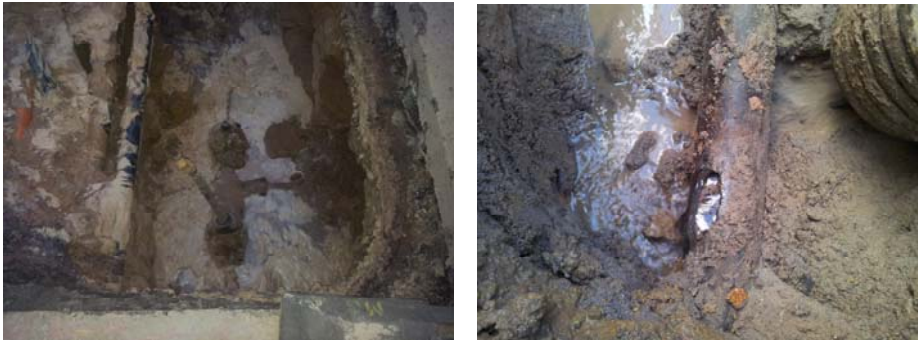
Bilder: Rohrbruch mit Scherbenbruch
